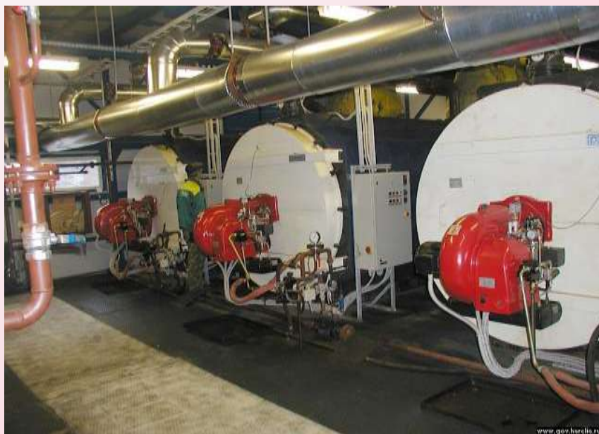
Котельная по ул. Ленина в г. Медвежьегорске после реконструкции
